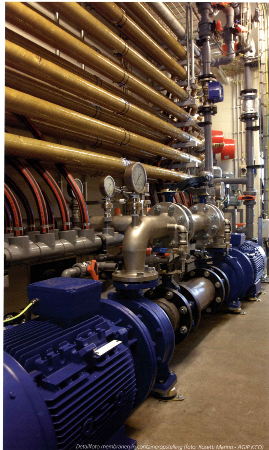
Detailfoto membranen in containeropstelling (foto: Rosetti Marino - AGIP KCO).
